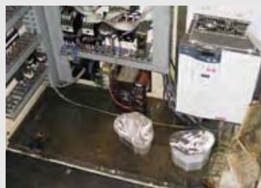
浸水した機械電気BOX内部
