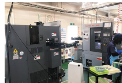
3つの工場でXC-100(写真奥)など8台のTAKAMAZ製品が稼働中。
