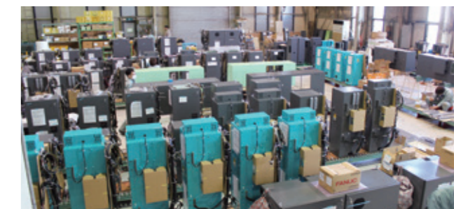
TAKAMAZ製品の制御盤や操作パネルが製造されている様子。作業中に放熱板などが傷つかないようにダンボール製のカバーを用意するなど、質の高い製品づくりのために工夫を凝らしている。
