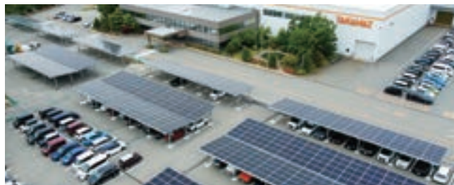
本社工場のカーポート型太陽光発電設備
