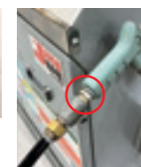
エアガン本体 (配管部)
